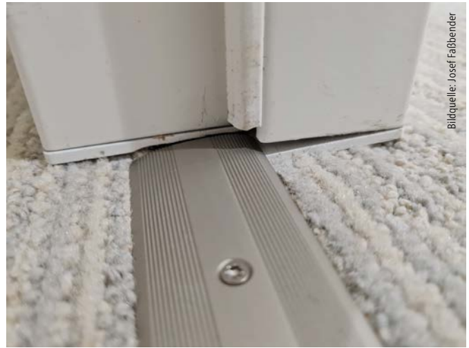
Abb. 5: Zarge zu hoch eingebaut, mit Holzkeilen „verlängert“, nicht dauerelastisch abgedichtet und Bodenschwelle zu schmal
