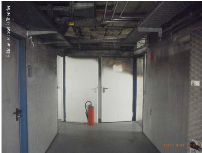
Abb. 4: Ungehinderte Brandausbreitung infolge verstellter Feuerschutzabschlüsse
