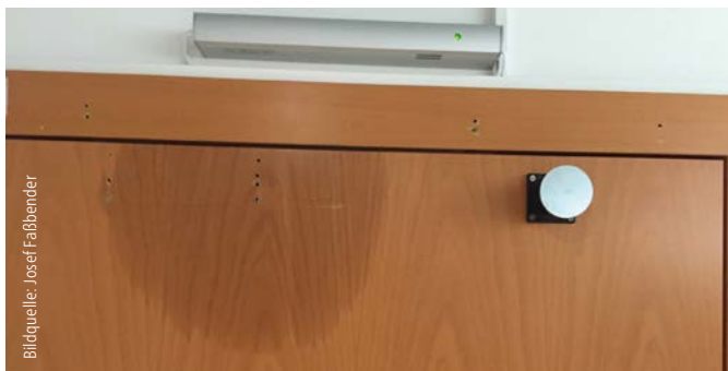
Abb. 6: Bei der versuchten unzulässigen Nachrüstung einer Feststellanlage, wurde der innenliegende Türschließer angebohrt
