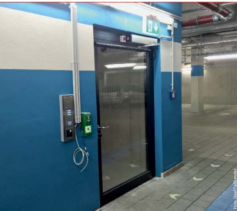
Abb.1: Notausgangstür mit Antrieb, Türzentrale und Zutrittskontrolle
