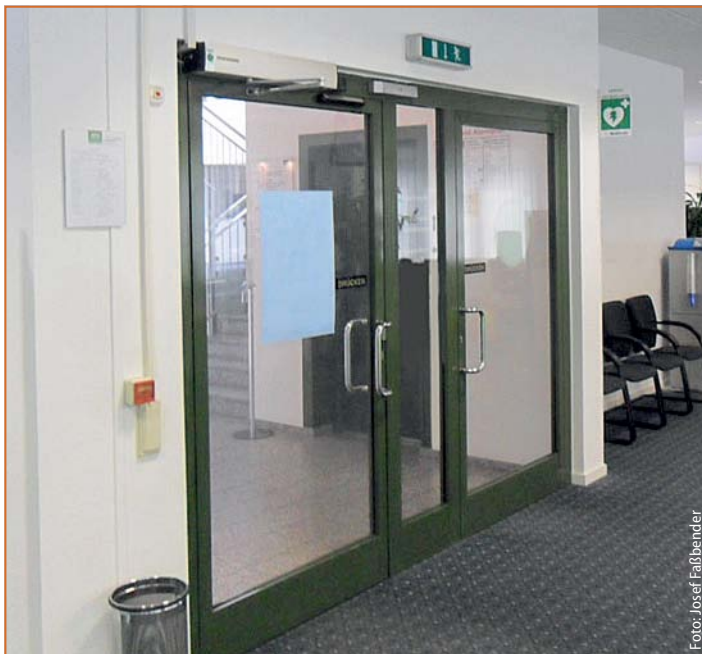
Abb. 1: Kundenzugang im öffentlichen Bereich: Drehflügelantrieb innen und außen nachträglich angebracht, Drücker gegen Stoßgriffe getauscht, nicht zugelassene Elektro-Öffner mit Tagesfalle eingebaut
