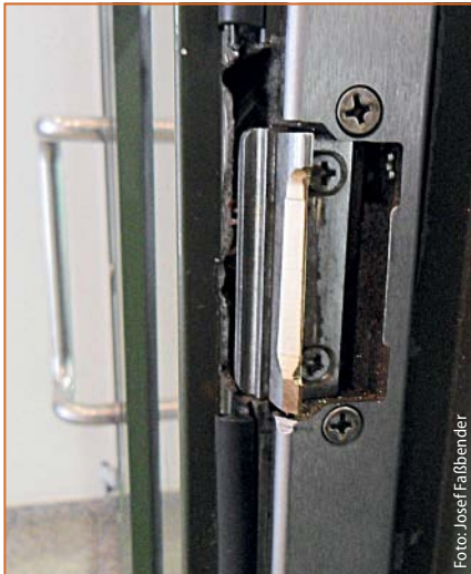
Abb. 2: Nicht zugelassener Elektro-Öffner mit Tagesfalle (s. Infokasten)
